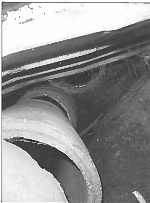
obr.3 DETAILNÍ POHLED NA TECHNICKÝ STAV POTRUBÍ
